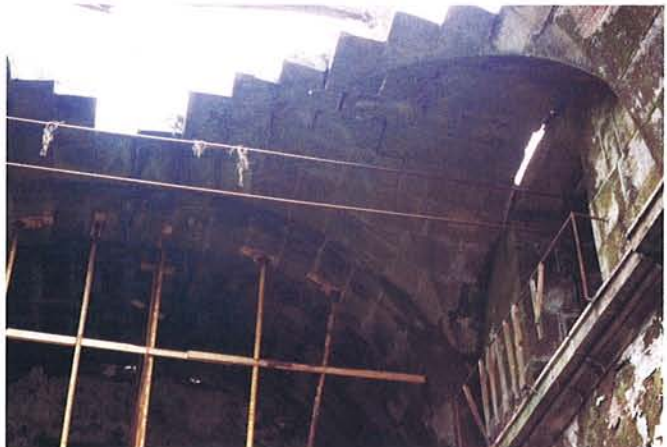
Figs. 4 y 5. Tirante de madera sobre la ruina de la bóveda.
