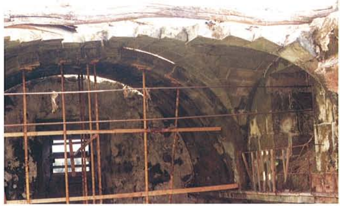
Fig. 9. Aspecto de los lunetos antes de la restauración, en muy precario equilibrio.
